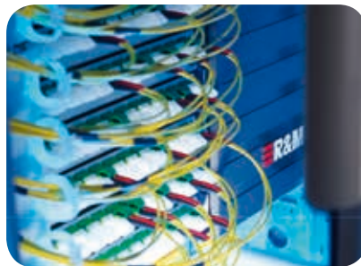
... Armoires de rue SCM
